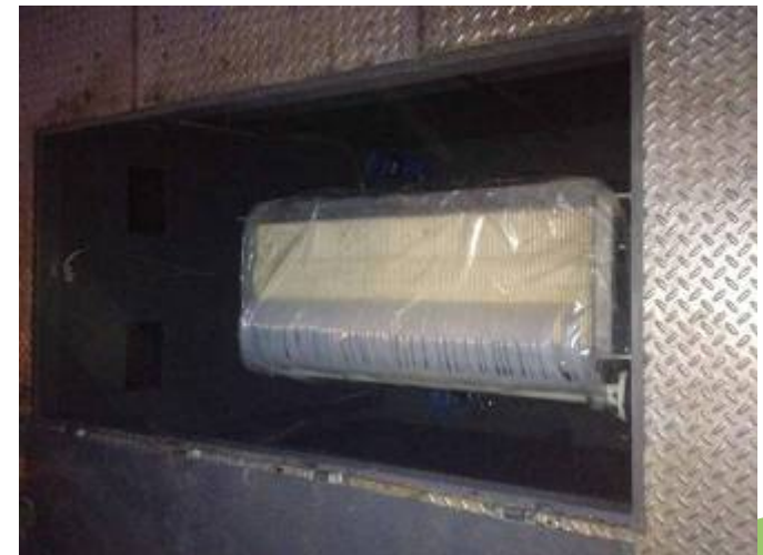
Inside MBR membrane
