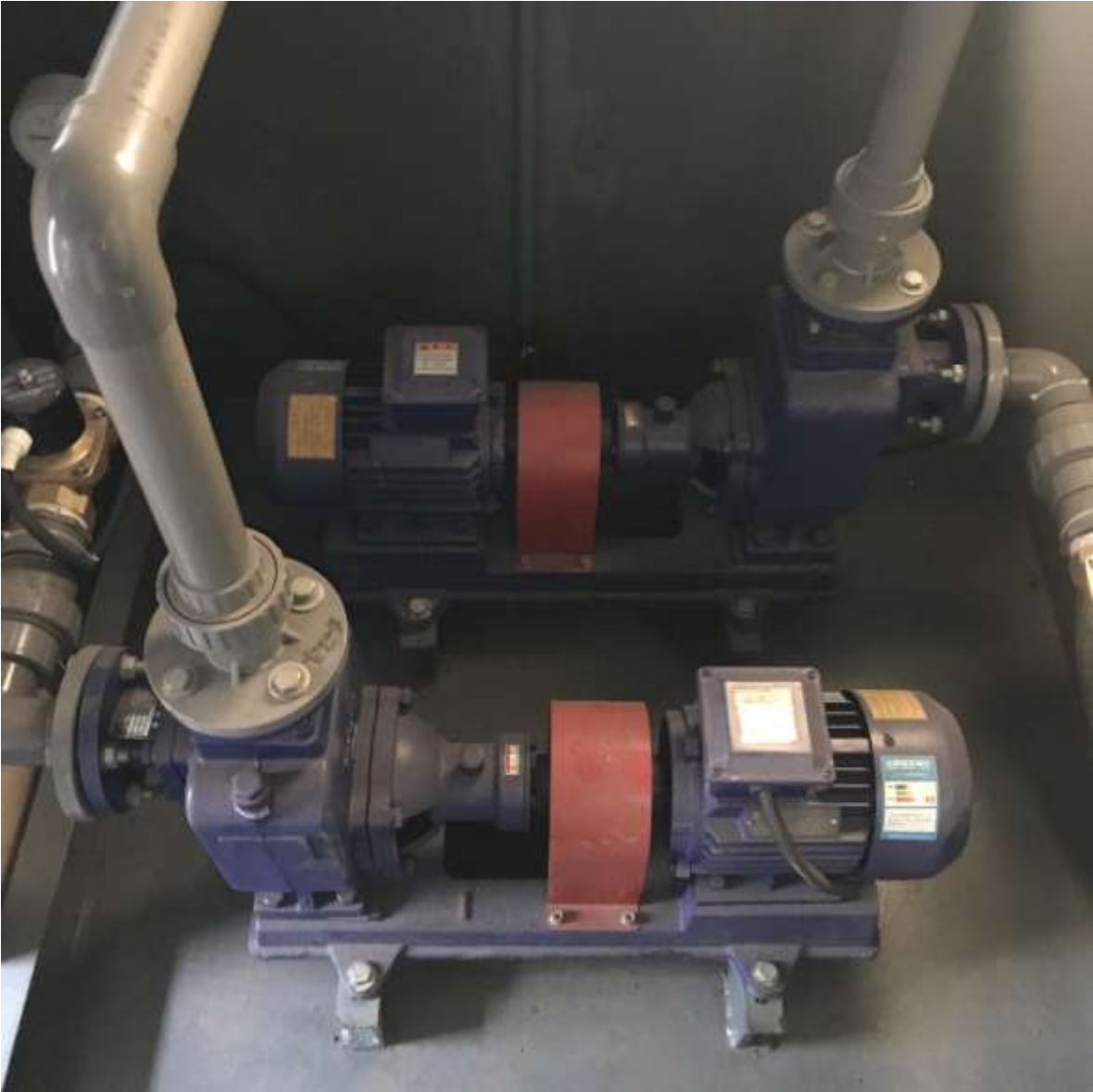
Bombas de Impulsión
