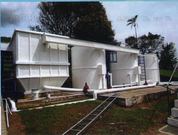
(Ptap de San Francisco, Provincia de Chiriquí, Panamá 16 LPS) Proyecto IDAAN, Blackwater Panama S.A.
