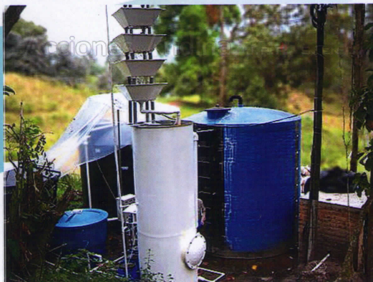
(Ptap de Industrias Lácteas La Vaca que Ríe, Silvania, Cundinamarca, Colombia 1,0 LPS) Proyecto Trataguas. Agua fuente: Pozo Profundo
