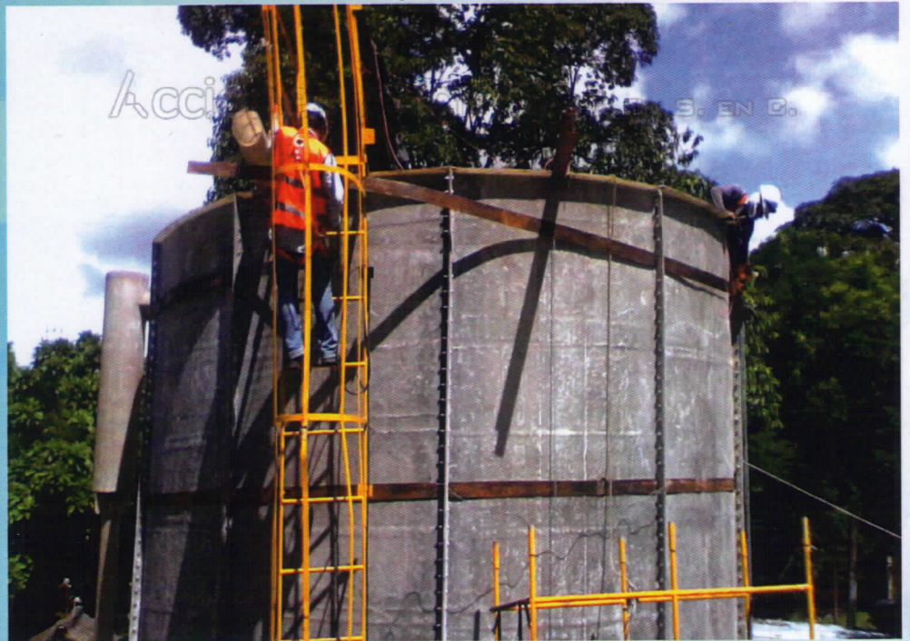
(Detalles constructivos en sitio, de tanques en PRFV. Tanque cilíndrico conformado por casquetes pernaadas)
