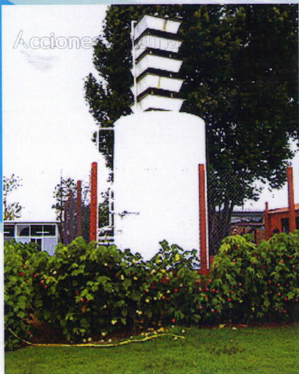
(Ptap del Colegio Unidad Pedagógica, Kmt. 5 Vía: Suba – Cota, Cundinamarca, Colombia 2,5 LPS) Agua fuente: Pozo Profundo
