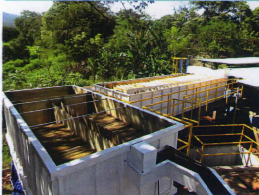
(Ptap de San Francisco, Provincia de Chiriquí, Panamá, 16 LPS. Detalle de tanques rectangulares interconectados: Módulos de Sedimentación con láminas de sedimentación inclinadas a 60 grados – Canaleta de conexión a filtros )
