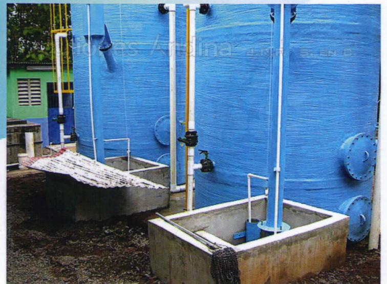
Sistema de Retro lavado independiente en cada tanque clarificador con registro de evacuación de lodos.
