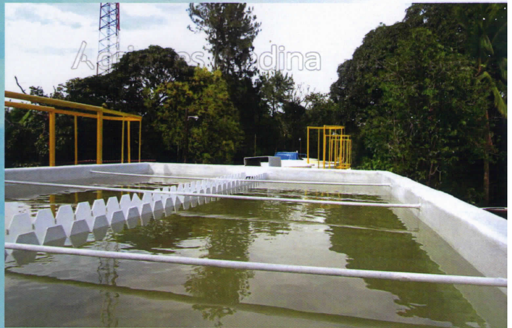
(Ptap de Santafe, Provincia de Veraguas, Panamá 16 LPS.. Detalle: Tanque Floculado - Sedimentador, Canaleta rompe sedimentos) Proyecto IDAAN, Blackwater Panama S.A.
