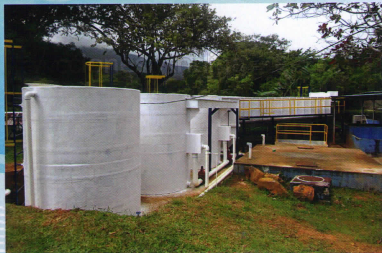
(Ptap de Santafé, Provincia de Veraguas, Panamá 16 LPS..Detalle de Filtros) Proyecto IDAAN, Blackwater Panama S.A.
