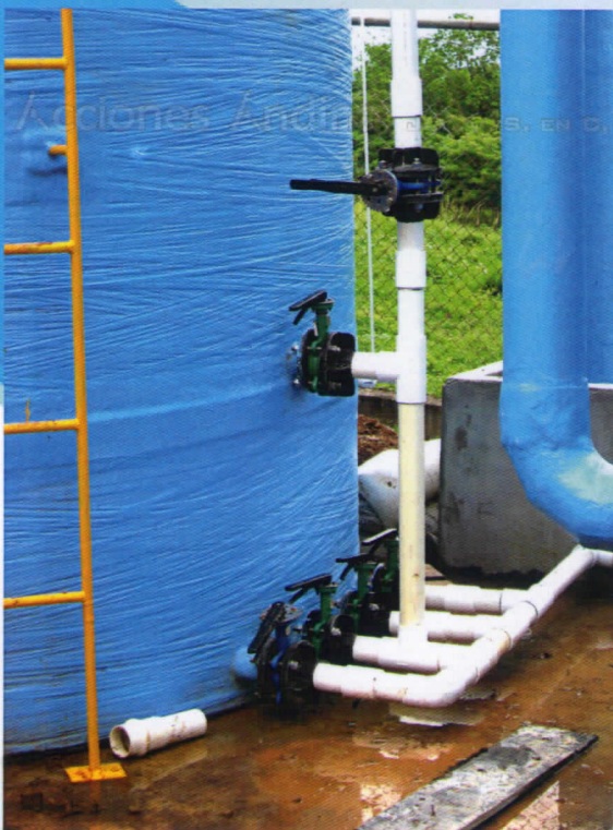
(Ptap de la población de Chiriquí, Provincia de Chiriquí. Panamá 16 LPS.. Detalle de Sistema de Retro Lavado de Filtros (válvulas tipo waffer de cierre rápido cuerpo en hierro dúctil), tubería en PVC presión a registro de expulsión de lodos)
